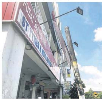
■告示牌从柱子上脱落。
